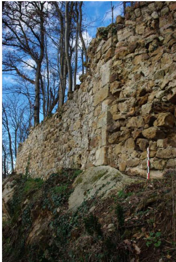
Élévation sud-ouest (partie) - Face externe - On reconnaît dans le développé du parement la chaîne de pierres de taille qui arrête l'élévation sud-ouest et à laquelle l'élévation sud paraît être adossée - Vue du sud-est vers le nord-ouest
