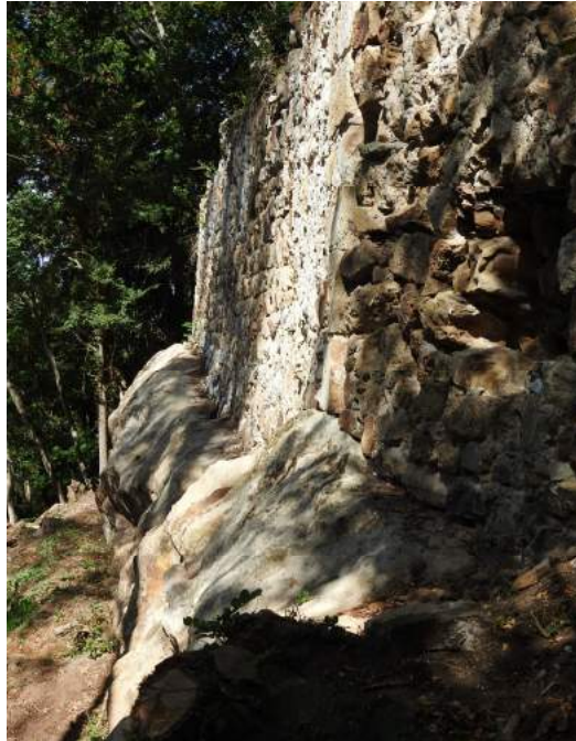
Elévation sud-ouest - Assise rocheuse aménagée - Au premier plan, en-deçà de la chaîne de pierres de taille, une part de l'élévation sud - Vue du sud-est vers le nord-ouest
